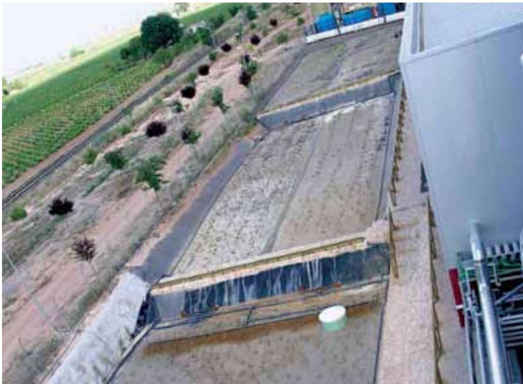
Imagen del humedal artificial de Alquimia.
